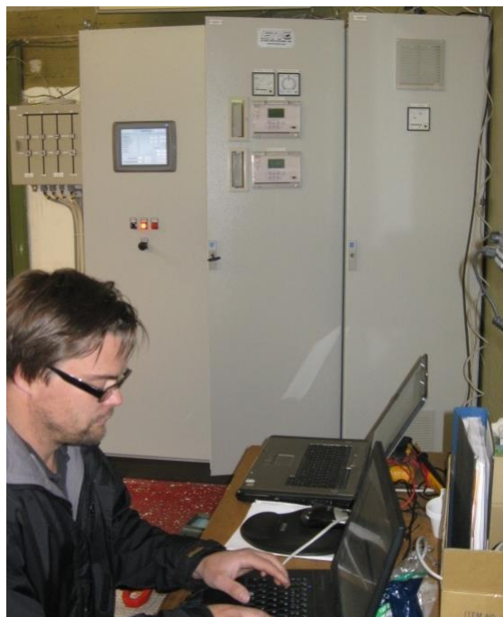
Idrifttagning av kontrollutrustning och EMB (skåpet t.h.) till en Kaplanturbin och generator på 3 MVA åt Lerums Energi
